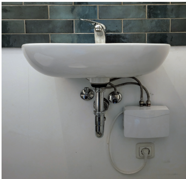
Dezentrale Warmwasserbereitung im Gäste-WC
