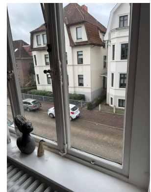
Holzfenster mit Einfachverglasung (Bild: Rittersdorf)
